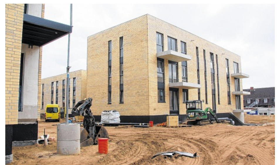
Im KLM-Haus F ist auch die Heizzentrale für den gesamten Bastianplatz untergebracht. BOOM
