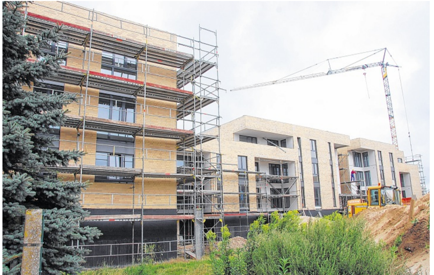
Bereits ihre volle Höhe erreicht haben alle fünf Häuser der Wohnungsgenossenschaft auf dem Bastianplatz.
